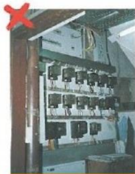
اتاق کنترل ناامن
